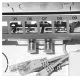
Montage du rép. TV sur le support métal
